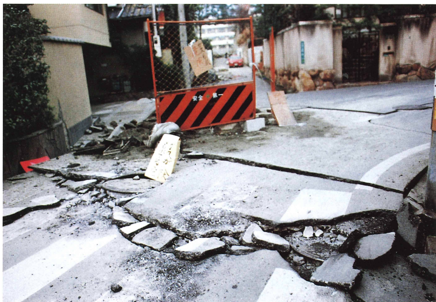
写真11 浅い谷戸の底に位置する緩やかな坂道、「ガスがもれてる危険」とある（西宮市久出ヶ谷町）
