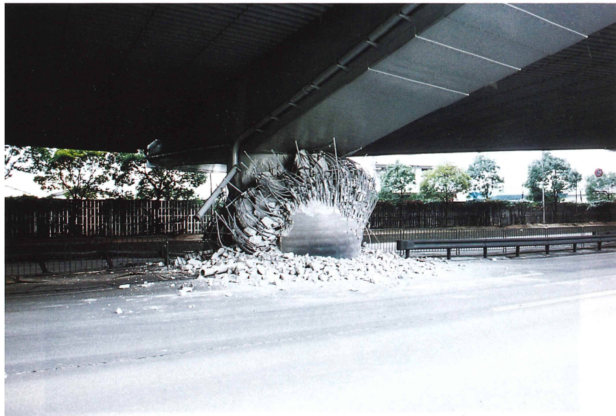
写真3 押し潰されたコンクリート橋脚（西宮市川東町）
