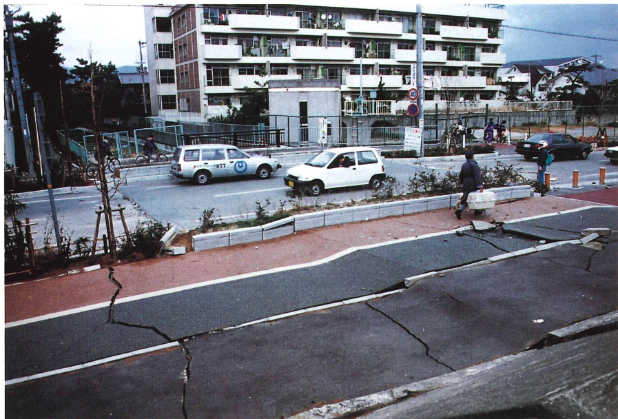
写真18 市境の小さな水路にかかる橋、前後に段差が生じ、舗装が引きちぎられている（芦屋市大東町から西宮市下葭原町方向を撮影）
