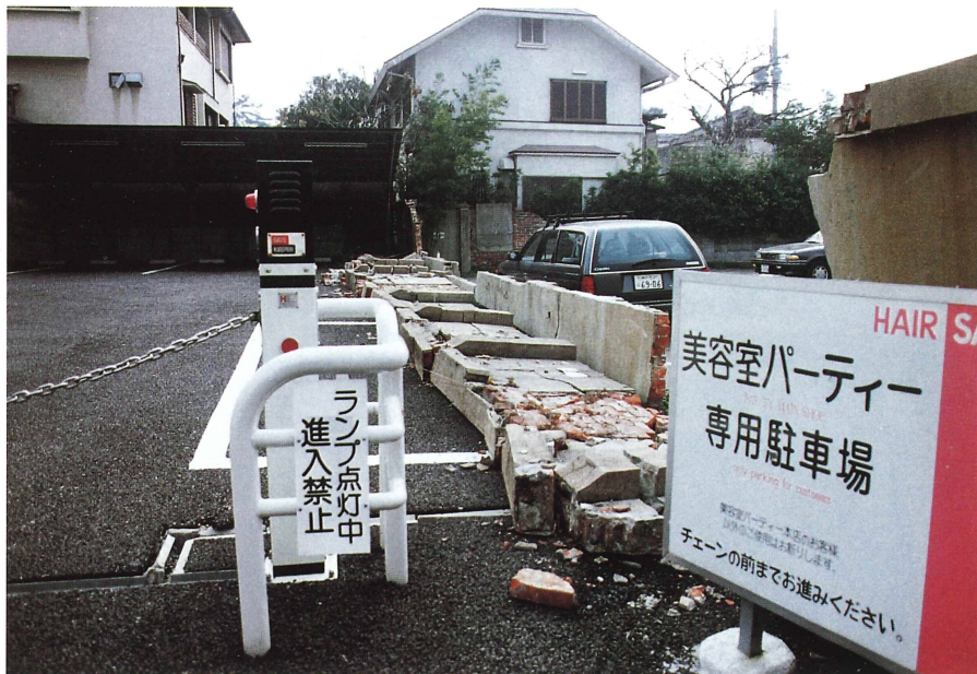
写真8 北側に倒れた駐車場の煉瓦塀、中段で折れた理由はよくわからない (西宮市相生町)
